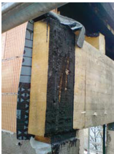
Bild 1 Brandspuren in einer Wiener Dachboden- bzw. Aufstockungs-Baustelle. Der durch Schweissarbeiten verursachte Brand konnte nach ca. 15 Minuten in der Anfangs- bzw. Entwicklungsphase des Brandes gelöscht werden.
